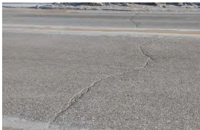
Рис. 1. Общий вид температурной трещины, возникшей на ул. Жорницкого г. Якутска
