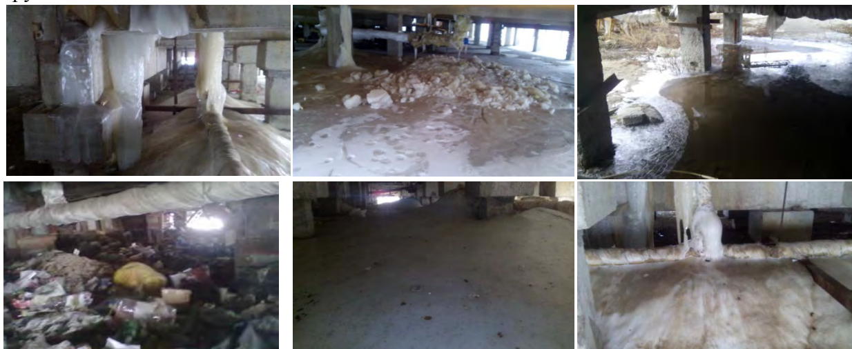
Рис. 1. Фактическое состояние подполий многоэтажных зданий
