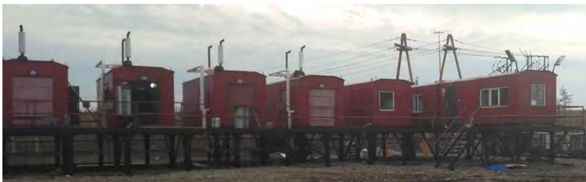
Рис. 2. Дизельная электростанция, село Себян-Кюель Кобяйского улуса Олекминского района.
