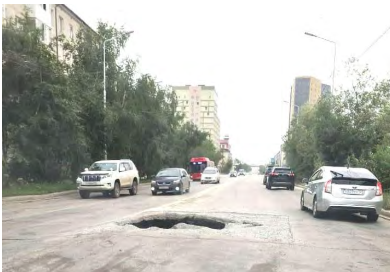
Рис. 4. Обвал дорожного полотна по улице Дзержинского над канализационным коллектором
