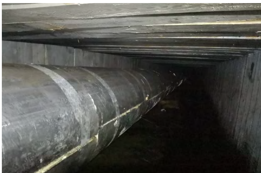
Рис. 2 Проходной канализационный коллектор
