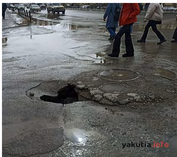
Рис.5 Выпучивание канализационного колодца и обвал грунта по проспекту Ленина (напротив ТЦ Проспект)
