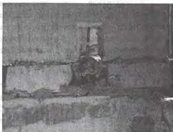
Рис. 2. Отсутствие сварки вертикальных тяжей, предназначенных для повышения сейсмической защиты здания
