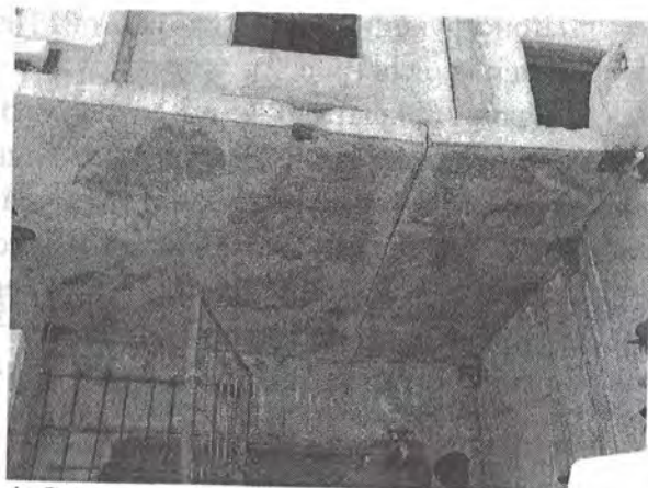
Рис. 4. Сквозная трещина на козырьке подъезда
