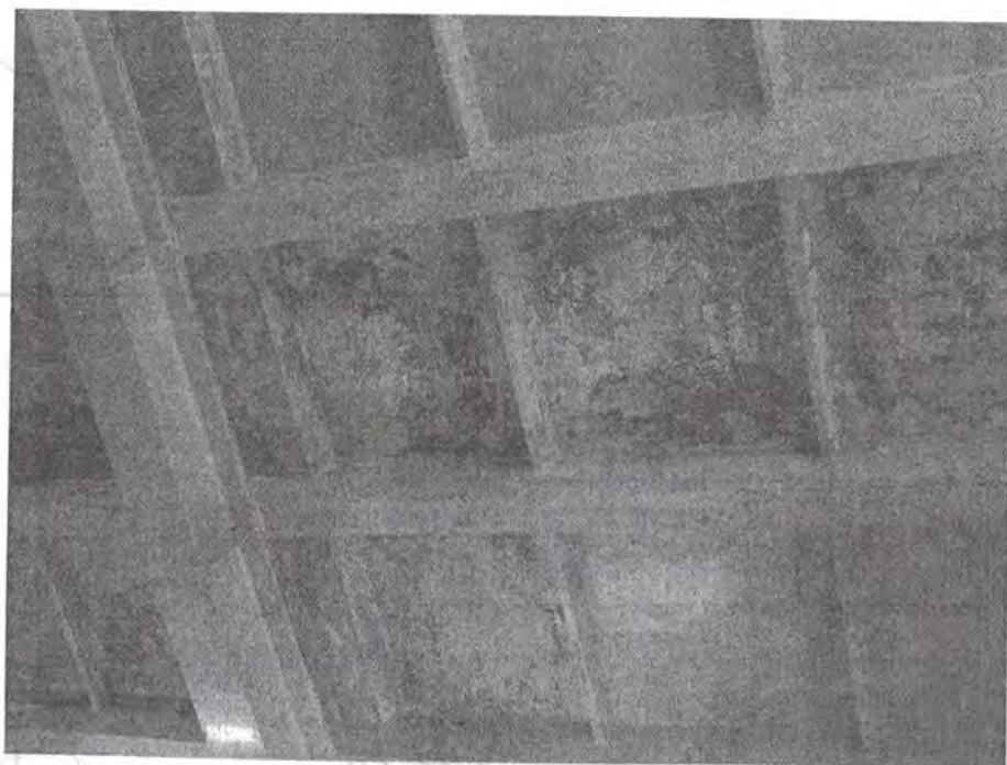
Рис. 4. Выщелачивание бетона на поверхности плит покрытия СОШ № 2
