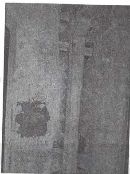
Рис. 6. Стык стеновых панелей (технический этаж) по оси Бс и 26с. Стык панелей не забетонирован
