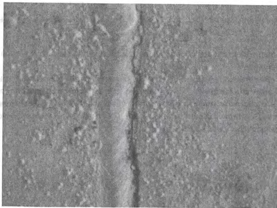
Рис. 6. Трещина около сварного шва по нижнему поясу балки по оси 11 СОШ № 2
